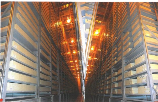
圖 21：書架間照明設備
