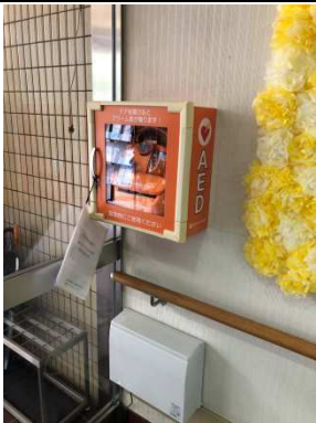
↑ 設有 AED 設備
