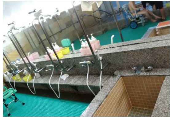
↑ 淋浴空間及設備
