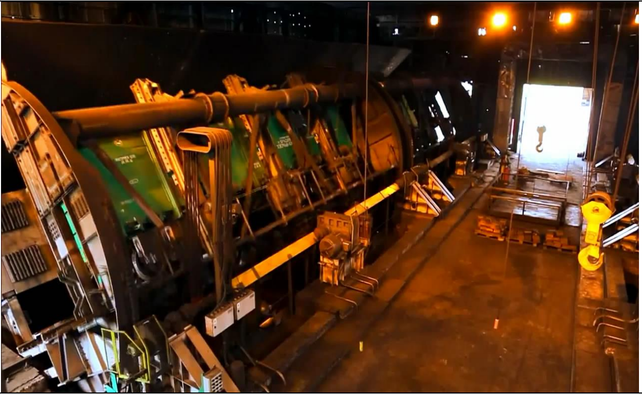
圖38：翻車卸煤設備外觀
