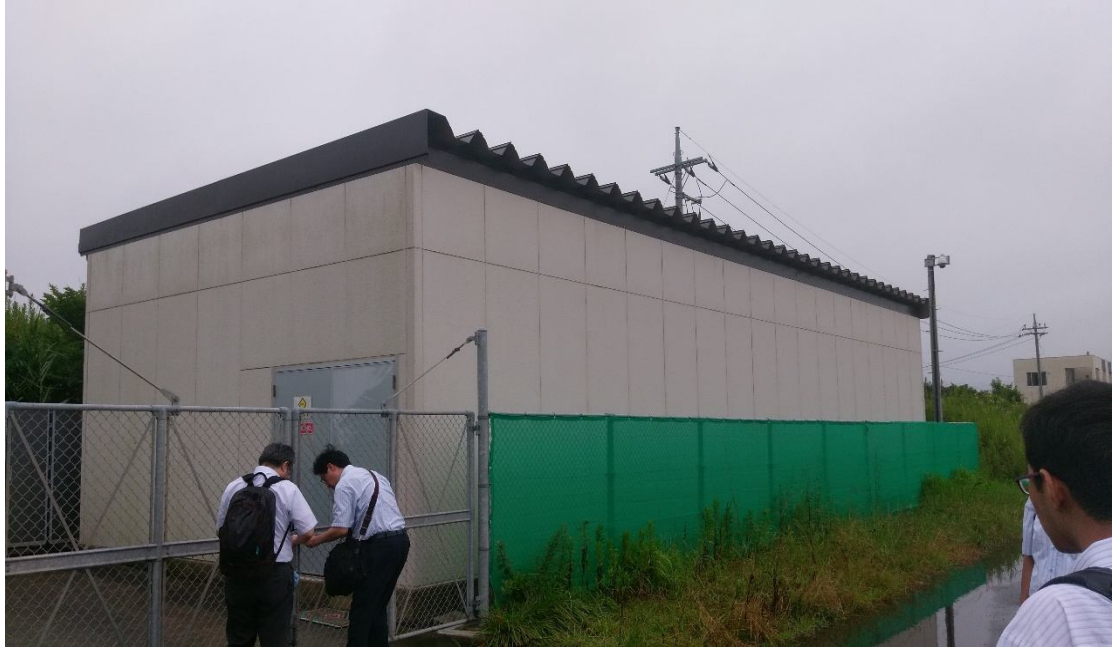
圖 18、千葉離岸風場陸上變電站外觀
