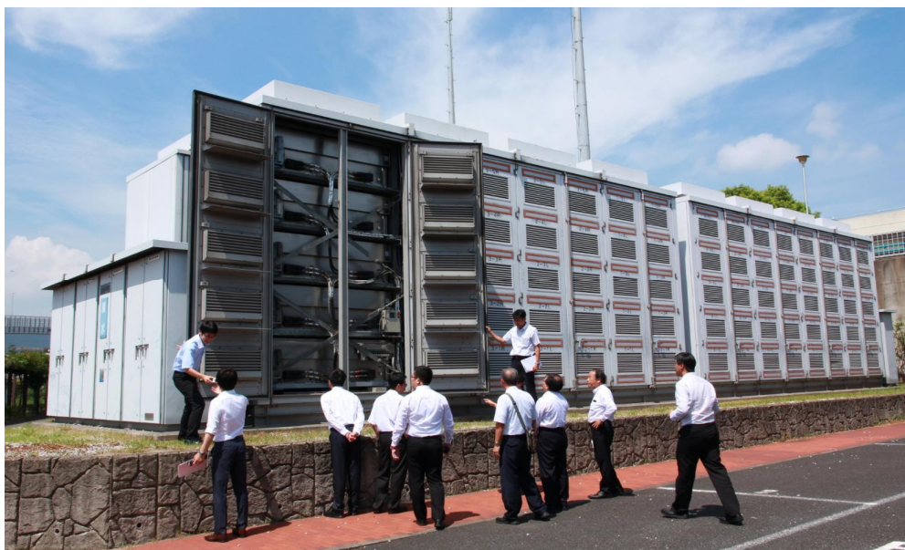
圖 28、NaS 2,000kW 電池儲能系統
