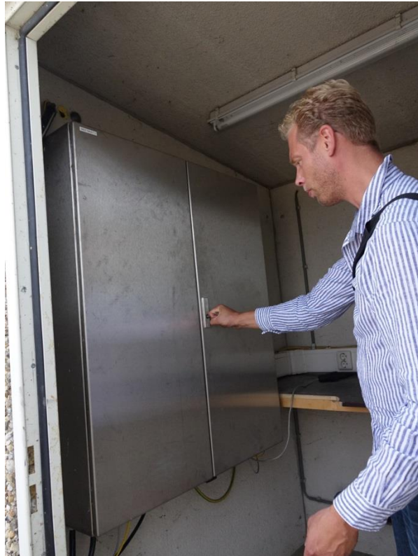
圖 18、氣象觀測塔旁電氣室
