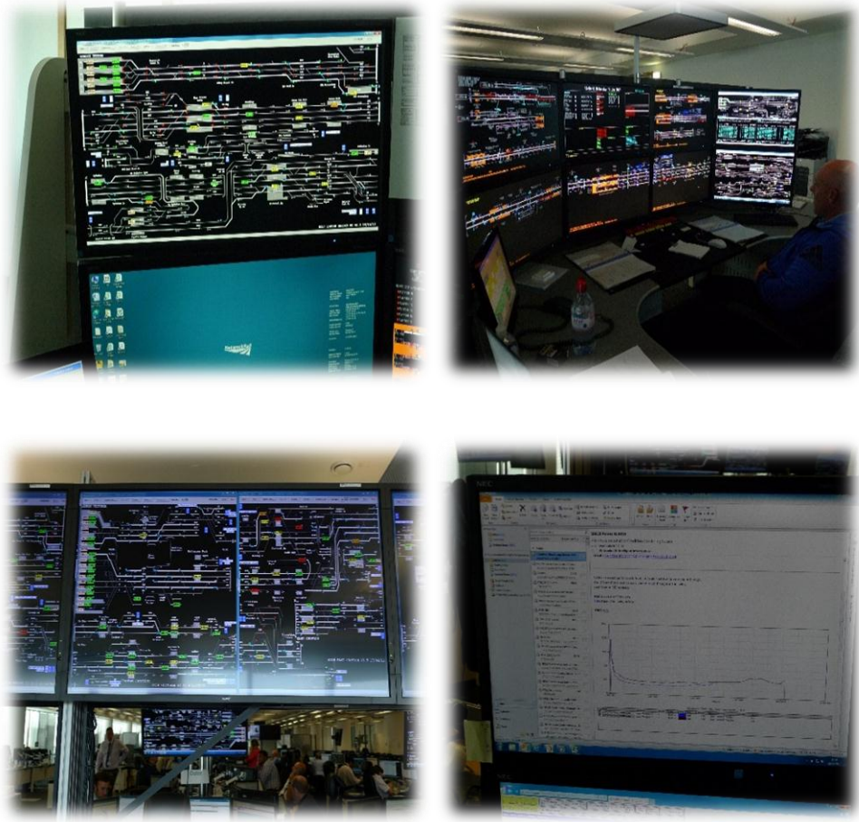
圖 41 綜合控制中心(OCC)
