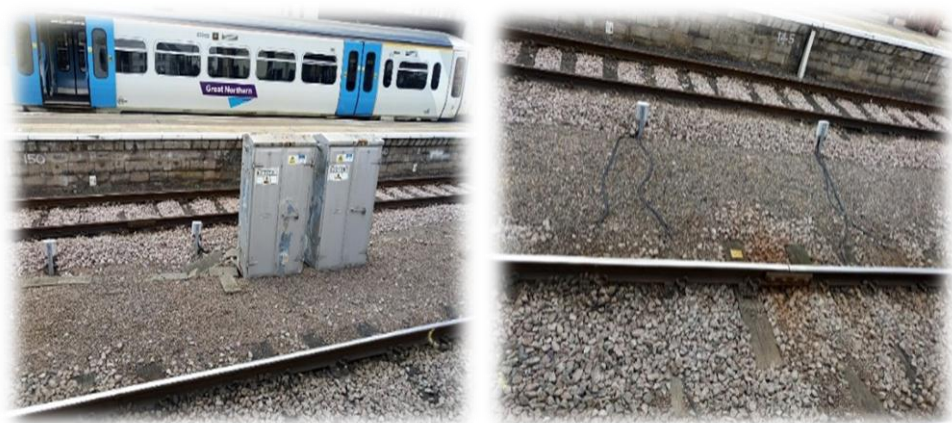
圖 28 道旁號誌設備
