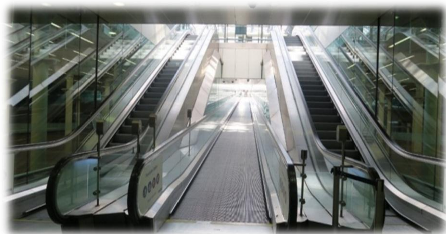
圖 21 車站上下樓層電扶梯及連接電動通道
