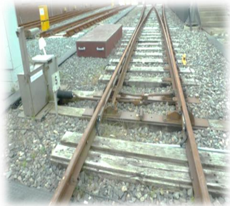
圖 69 油壓式轉轍設備
