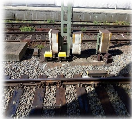
圖 79 道旁號誌設備
