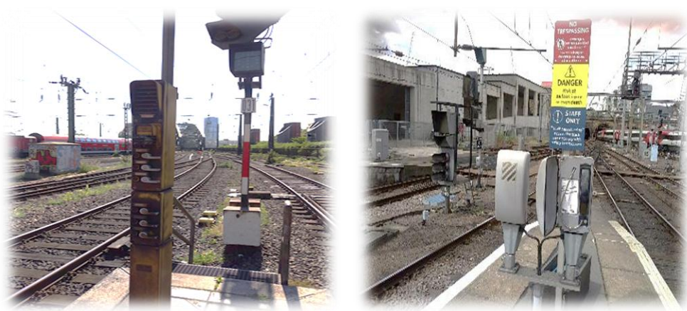
圖 82 月台兩末端處設號誌手動開關及維修電話
