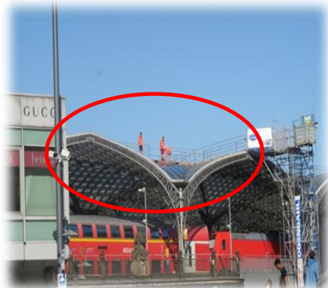
圖 77 高空設備維修工作平台
