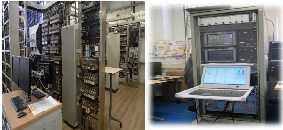
圖 70 繼電聯鎖設備及 ERTMS Level 2 的模擬器
