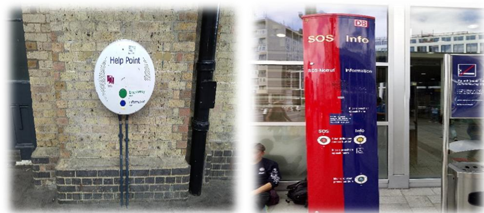
圖 83 車站內緊急求救按鈕通話設備
