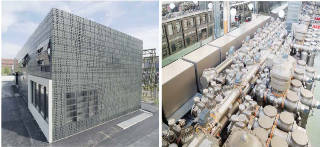
圖 2 第一座創新絕緣氣體的生態高效 GIS 設備變電站於蘇黎世
