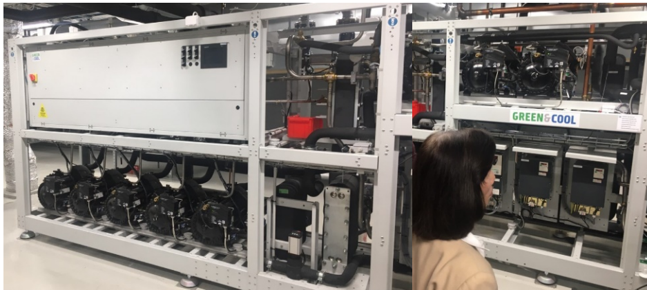
圖 4、二氧化碳作為冷媒製冷或加熱的設備
