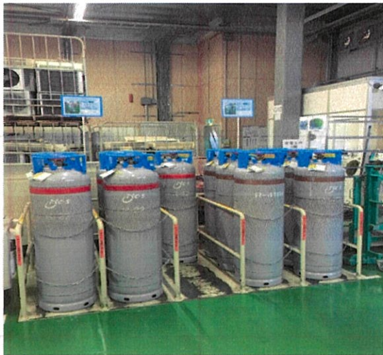
冷媒回収設備
