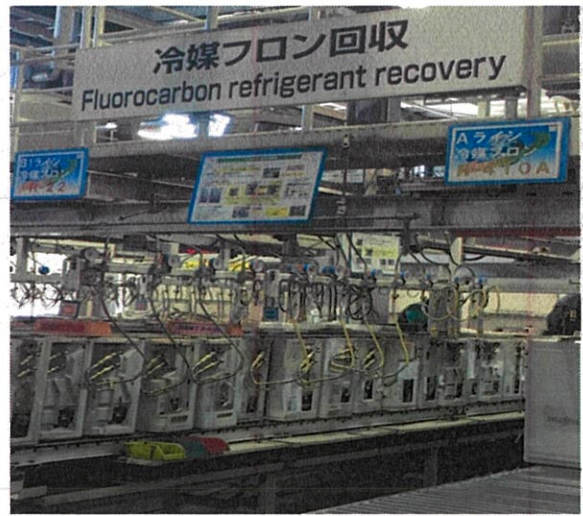
冷媒回収設備
