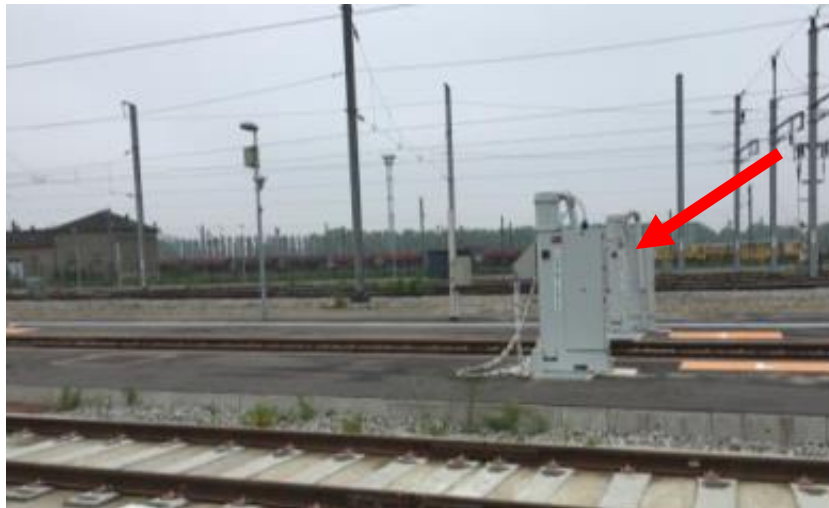
圖 3.2.29 車廠加砂設備
