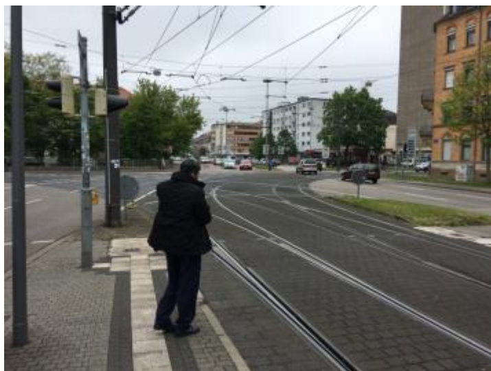
圖 3.3. 1 德國 Karlsruhe Tram-Train 電車線系統
