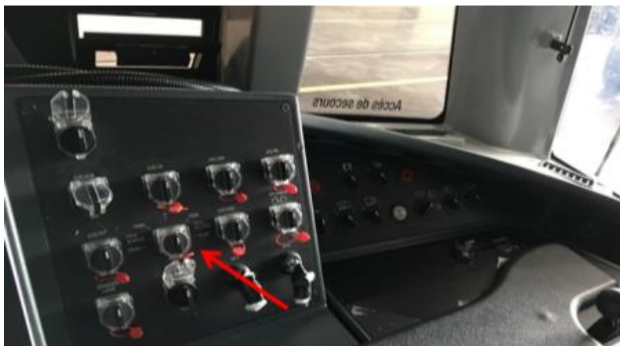
圖 3.3.12 法國 Mulhouse Tram-Train 切換開關
