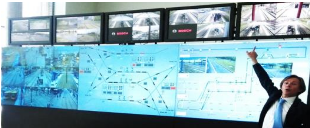
圖 3.4.12 法國 Mulhouse Tram-Train System 的行車控制中心
