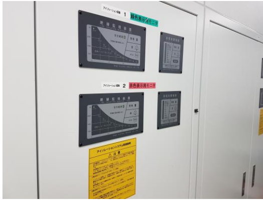
圖十三 開刀房配電盤
