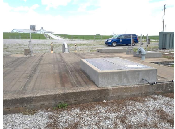
廢水先匯集至地下儲存槽
