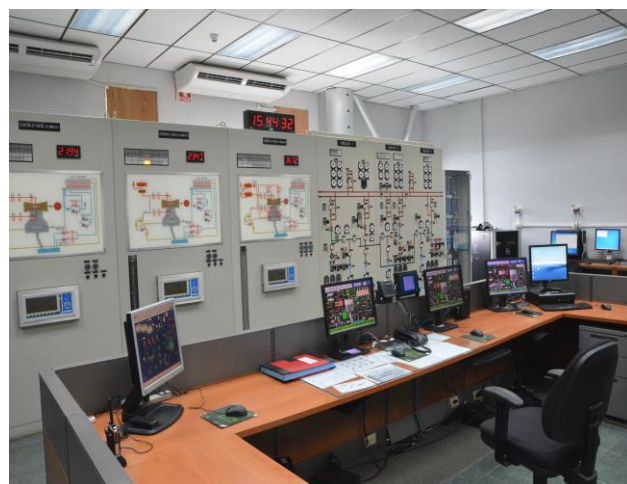
照片 16-2 地熱機組控制室
