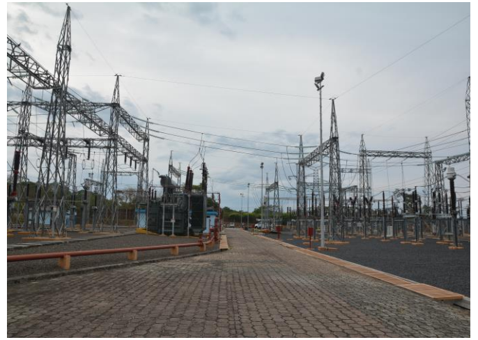
照片 16-4 與地熱機組相連之輸電公司開關場
