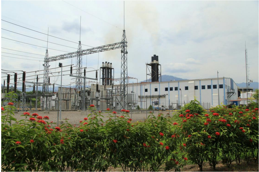
照片 15 CEL 轄下 INE 火力電廠
