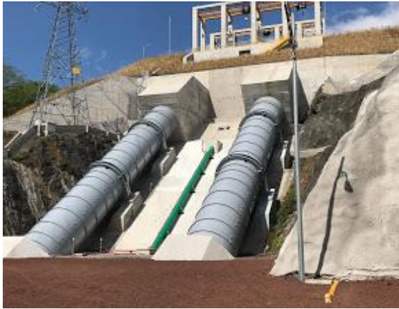
照片 14 壓力鋼管
