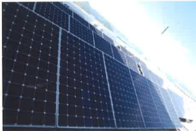
圖13 安裝在天台的光伏板
