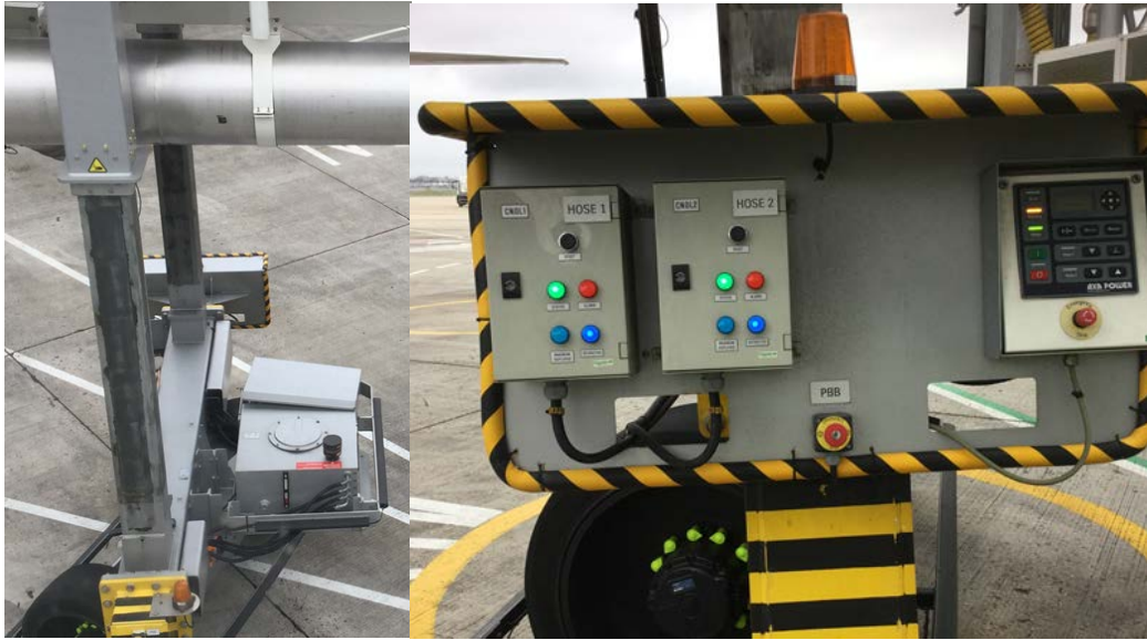
圖 4.5.2 旅客空橋系統-油壓式升降柱（左）及風管操作盤（右）
