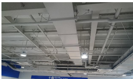
圖：關西機場第二航廈擴建區室內管線以明管方式佈設
