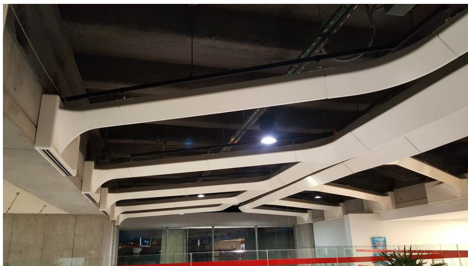
圖 7.2 戴高樂國際機場第一航廈，特殊造形之空調風管可同時滿足功能與美觀需求
