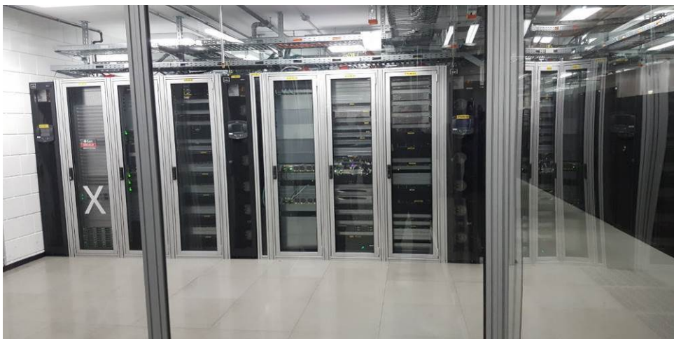
圖7.32 法蘭克福國際機場IDC機房
