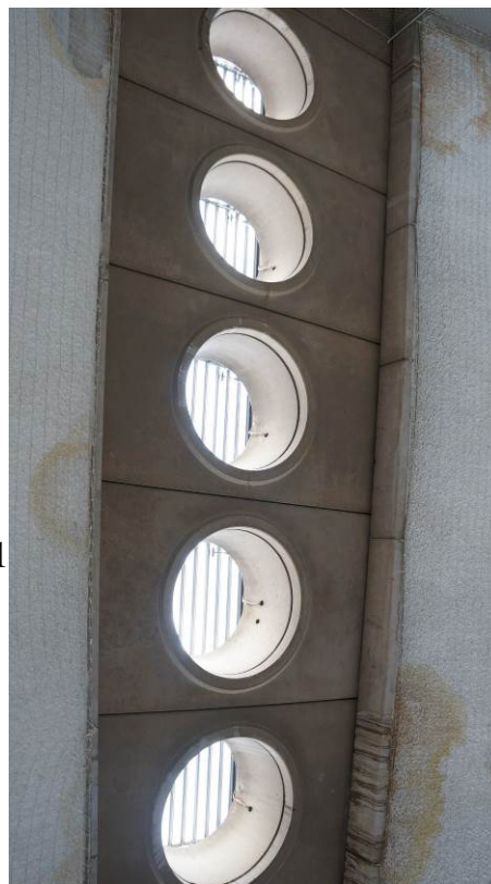
圖 7.7 戴高樂機場自然排煙窗 2
