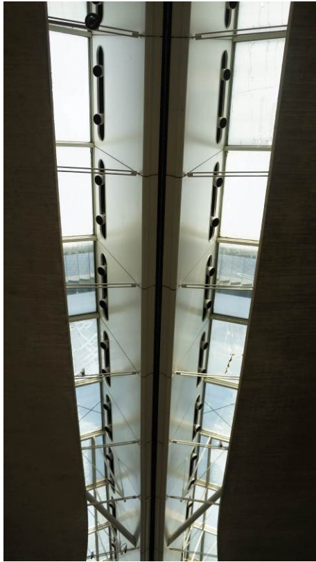
圖7.7 戴高樂國際機場自然排煙窗1
