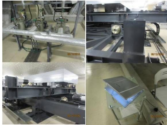
圖 26 東京中城(Tokyo Midtown)大樓的高樓層主動重力阻尼器
