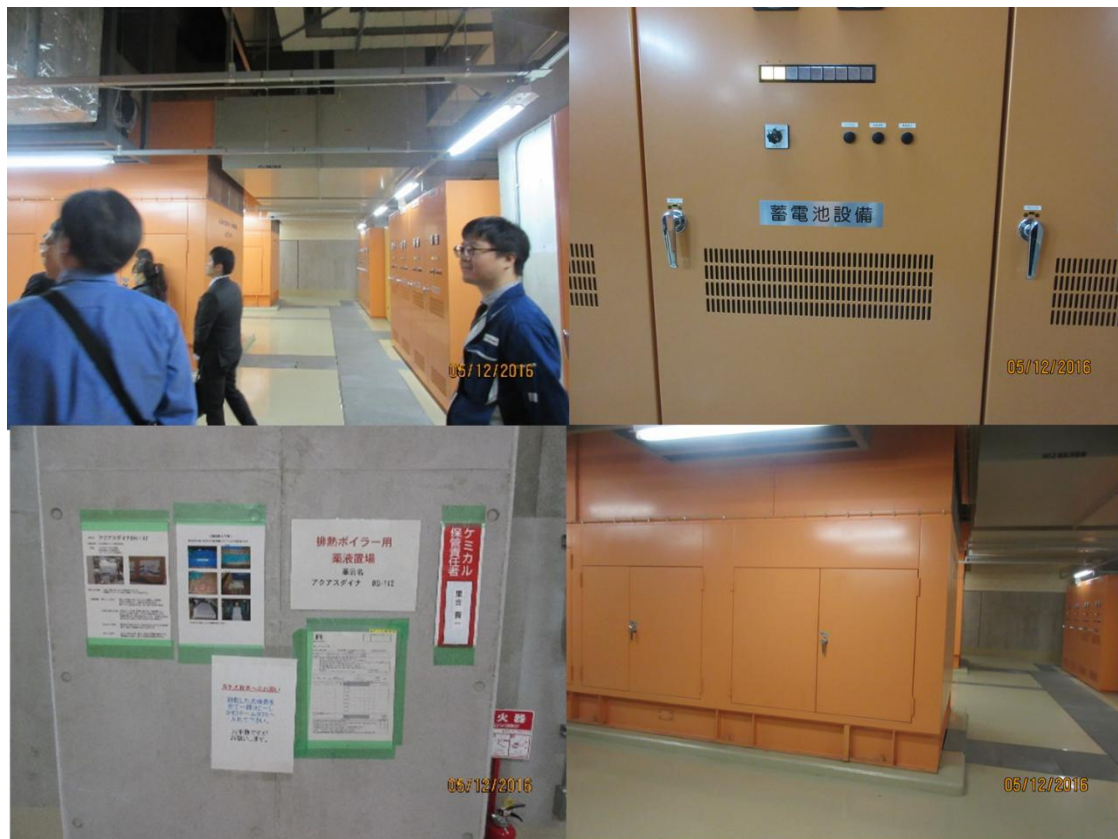
圖 25 東京中城(Tokyo Midtown)大樓的機電設備
