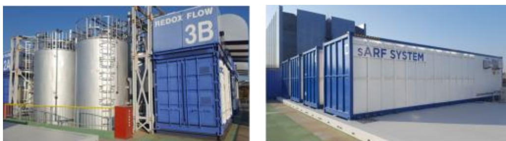
圖 7、橫濱製作所第一代及第二代液流電池設備實拍。
