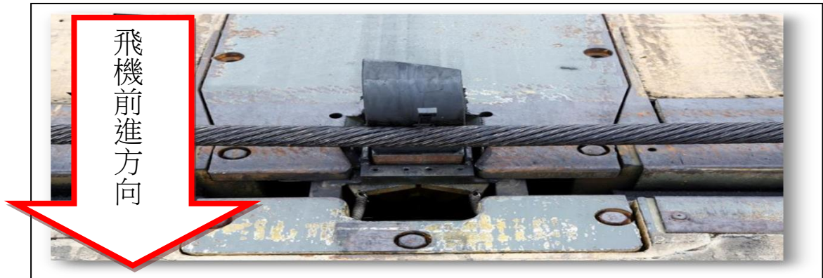
圖一 損壞之 BAK-14 攔截鋼繩支撐塊
