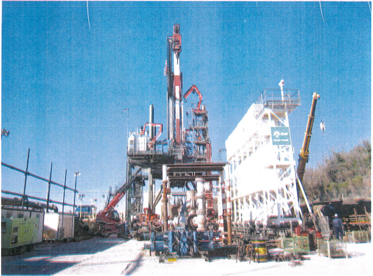
照片十九 HH 系列鑽機實地參訪
