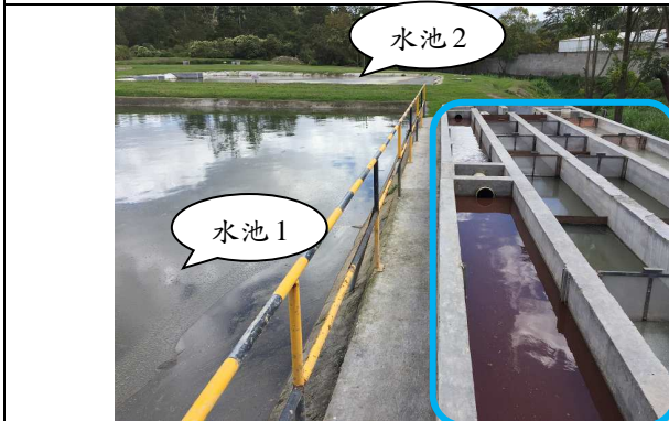
污水處理槽(藍框顯示)及 2 個水池
