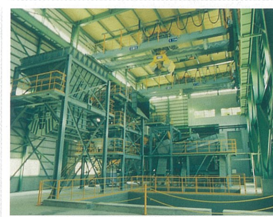
焼却残さは選別機で金物等の異物を除去し、セメント 原料として資源化しています。
