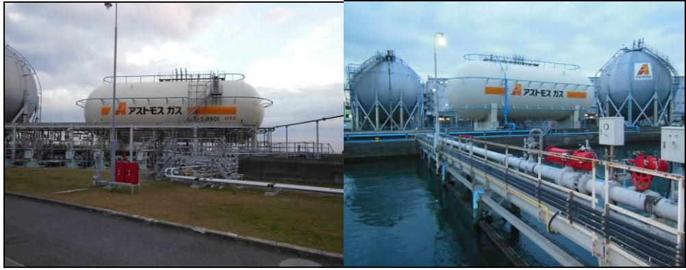
圖十七 Ichikawa Terminal T1 高壓槽現況
