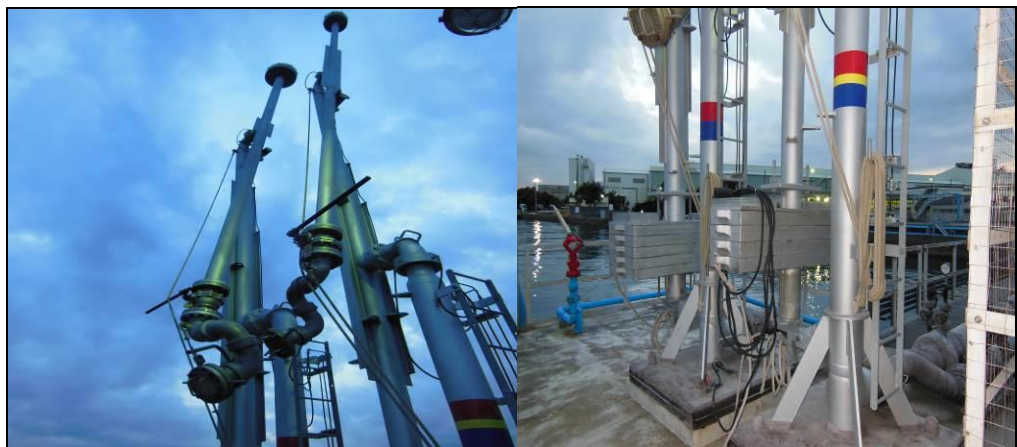
圖十九 Ichikawa Terminal 碼頭卸油臂等設備
