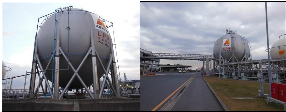
圖十五 Ichikawa Terminal T5 及 T4 高壓槽
