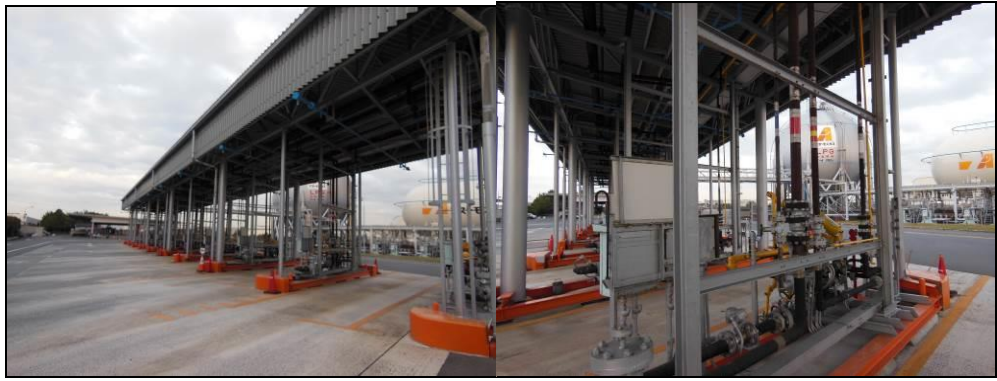
圖十四之一 灌島區現場圖(現場有十個車道可供灌裝)
