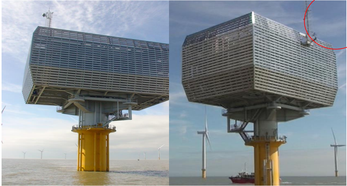
圖 17 Gunfleet Sands 離岸變電站與其通訊及監控天線設施
