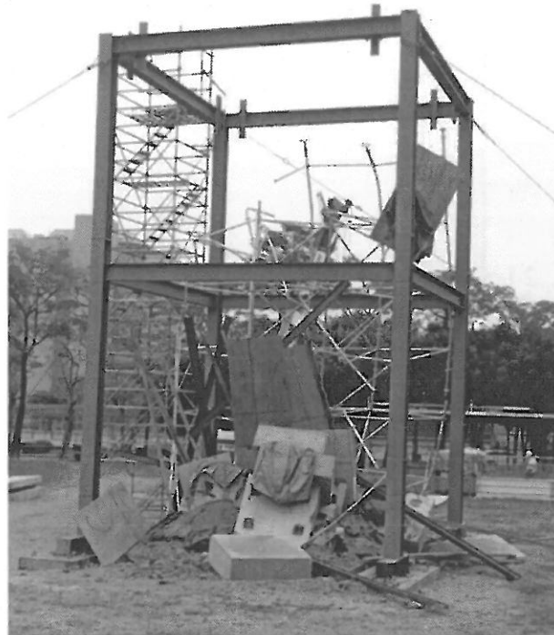
圖16 盤扣式鷹架室外試驗加載最後整體結構系統破壞情形
