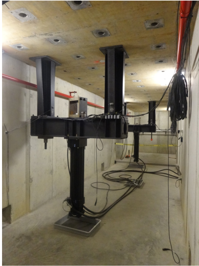
圖 14 安裝於強力地板地下室的油壓致動器
