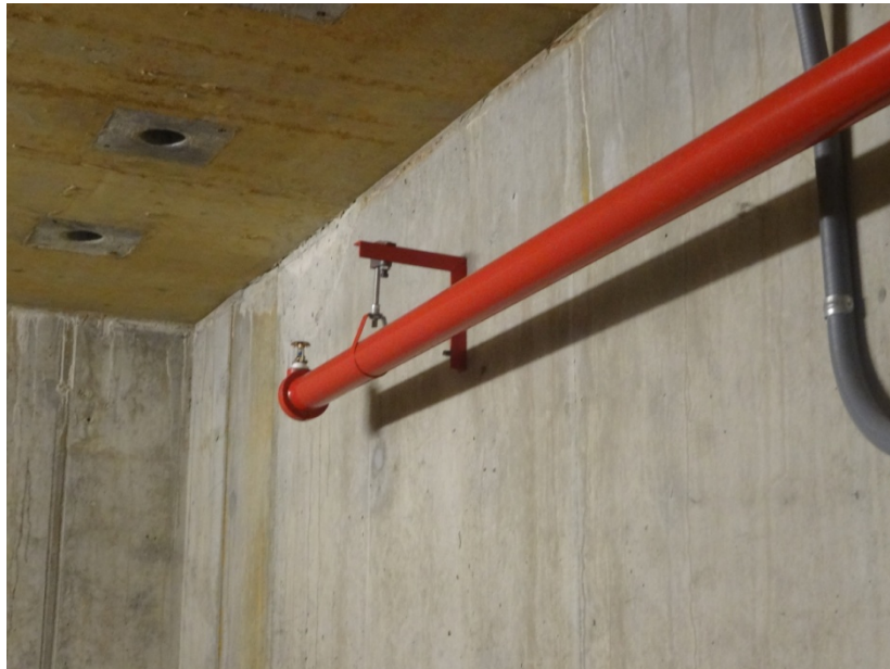
圖 15 強力地板地下室的消防設備
