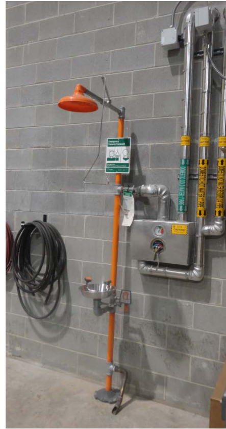
圖 28 緊急沖洗裝置
