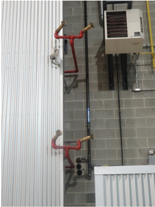
圖 16 實驗室的消防設備
