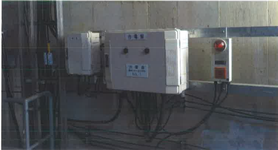
圖 3-9 洞道內電源分電盤
