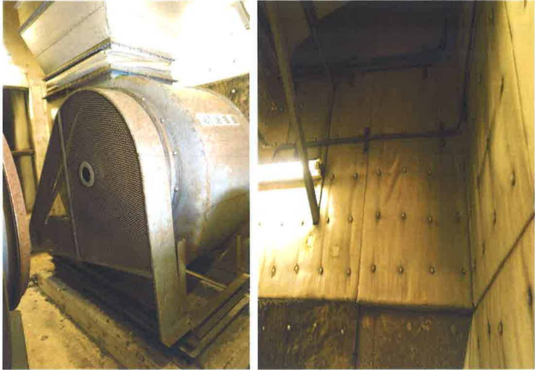
圖 3-5 小曾根線多翼風扇(離心型)及防噪音裝置(直井內貼附吸音材)
