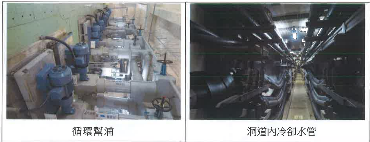
圖 2-8 間接水冷卻系主要設備照片
