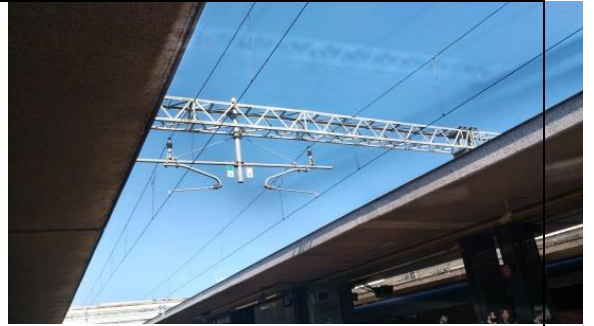
義大利國鐵 正線 OCS 系統裝置
