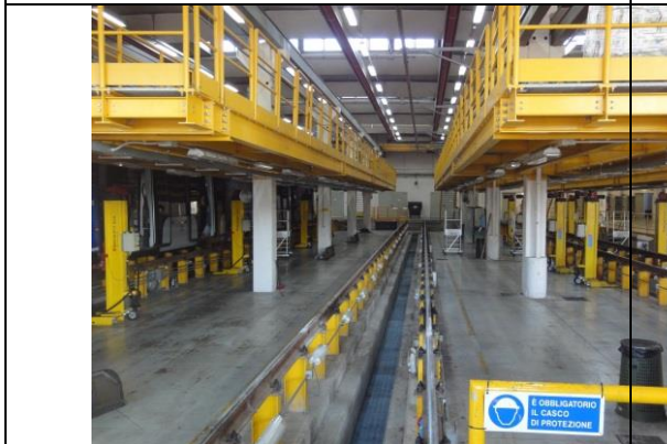
主維修機廠維修線(地下維修坑、 車頂維修平台)
