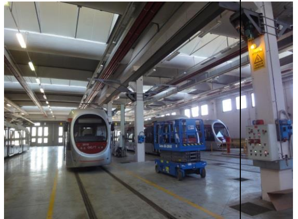
主維修機廠維修線(導電軌)
