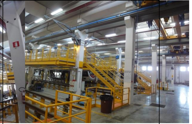
主維修機廠維修線(架空式吊車)
