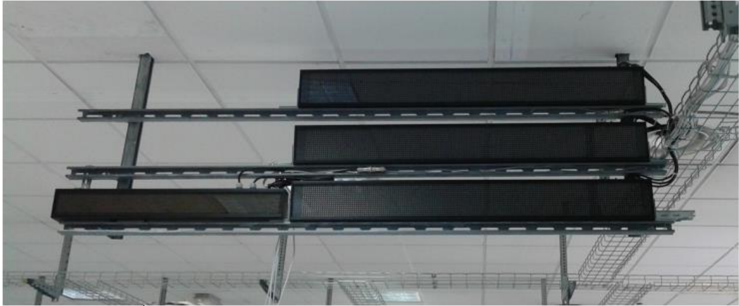
圖 2.1.26 出廠測試-列車內外部 旅客資訊顯示系統(PIDS) 現場實體設備照
