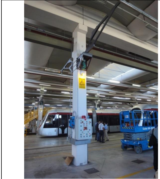
主維修機廠維修線(導電軌)
