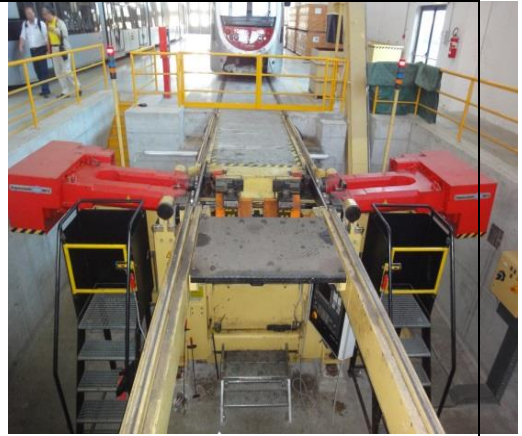
主維修機廠(地下車輪床台)
