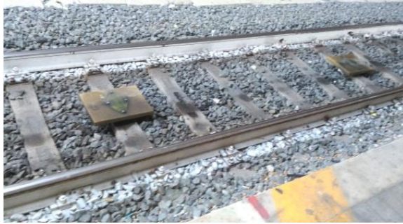
義大利國鐵 正線號誌系統裝置
