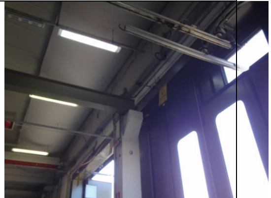
進主維修機廠日檢線(OCS 供電 轉換軌)
