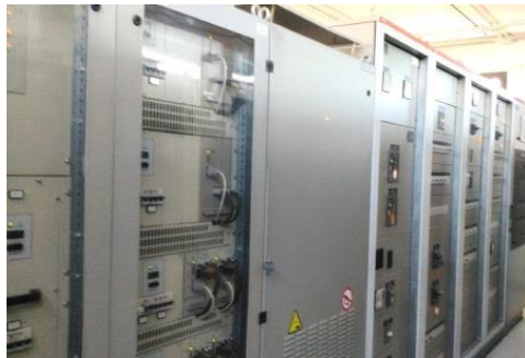
機廠變電站內部
