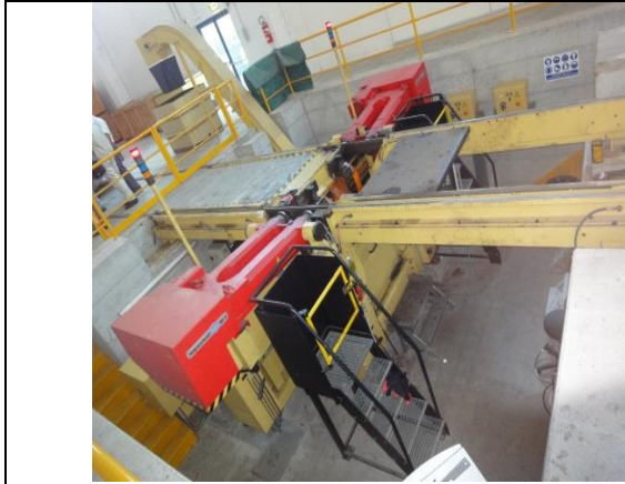
主維修機廠(地下車輪床台)
