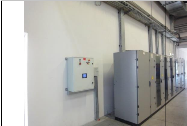
主維修機廠維修線(直流供電箱)
