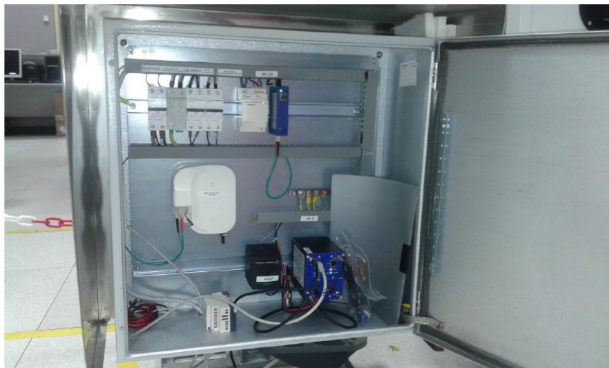
圖 2.1.28 出廠測試- WiFi AP 模擬器機櫃現場實體設備照 出廠測試經督導人員實際觀察，專業分包商 Thales 係依據淡海
