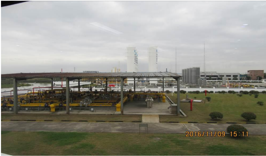
張家港港華燃氣有限公司鳳凰天然氣配氣站
