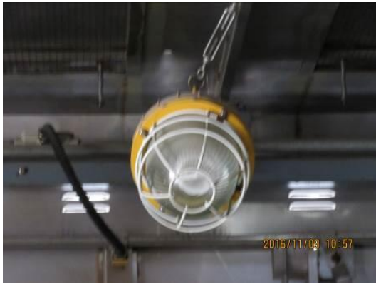
崑崙燃氣公司台玻整壓計量站 防爆燈具
