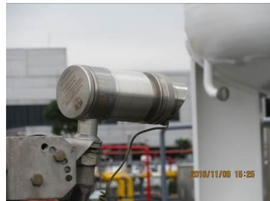
港華燃氣有限公司鳳凰天然氣配氣站 火焰偵測器
