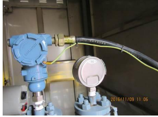
崑崙燃氣公司台玻整壓計量站 壓力傳送器
