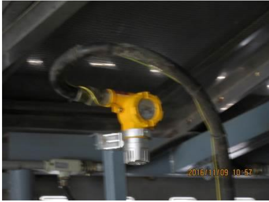
崑崙燃氣公司台玻整壓計量站 瓦斯偵測器
