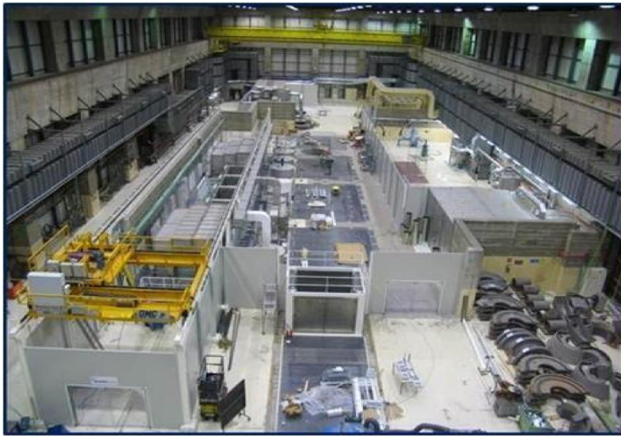
圖14 Caorso核能電廠汽機廠房建置廢料處理管理設施
