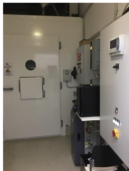
大型絕氧除蟲設備
