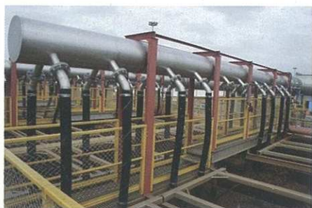
86,000 吨/天 市政污水MBR系统
