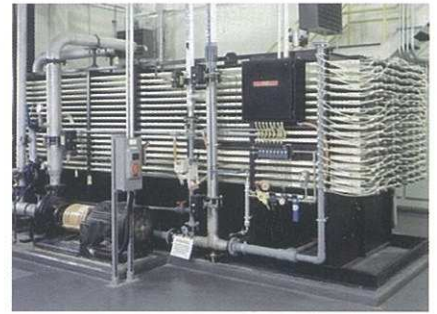
管式膜乳化油废水处理
