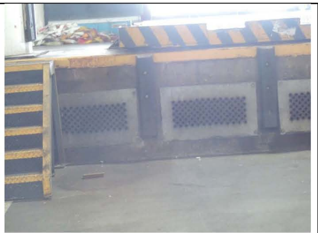
卡車碼頭之換氣設備
