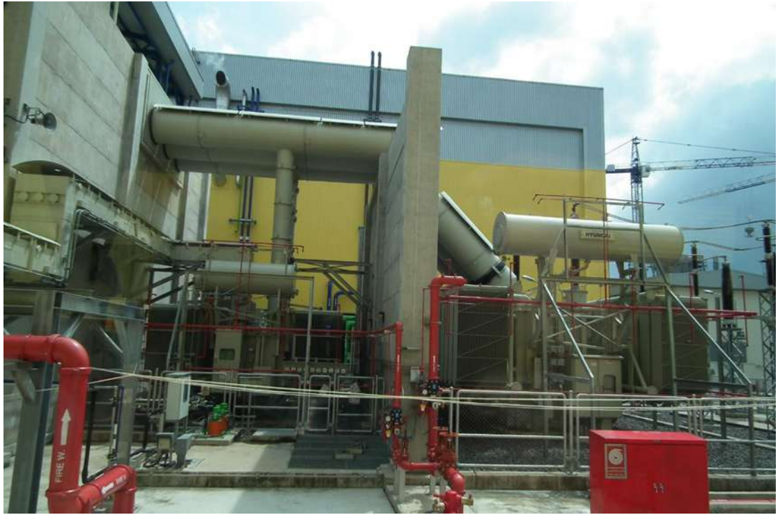
圖 49 2 號機升壓變壓器即輔助變壓器
