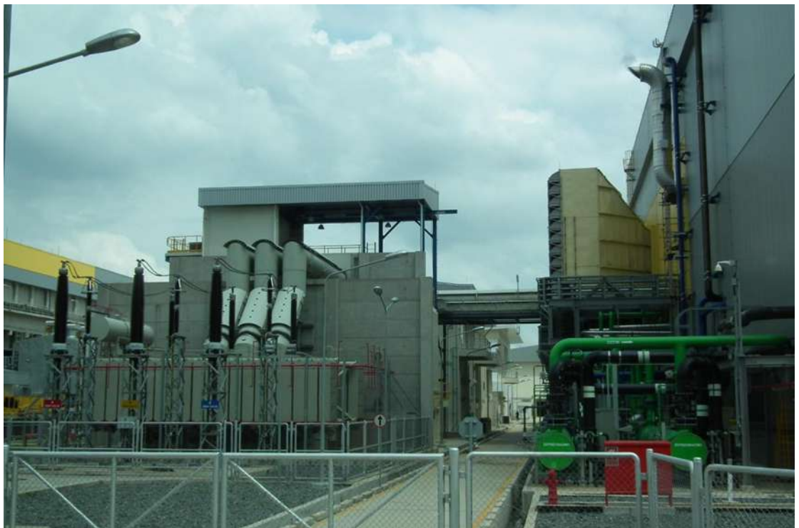
圖 50 2 號機氣渦輪機進氣口及經 IPBD 升壓變壓器
