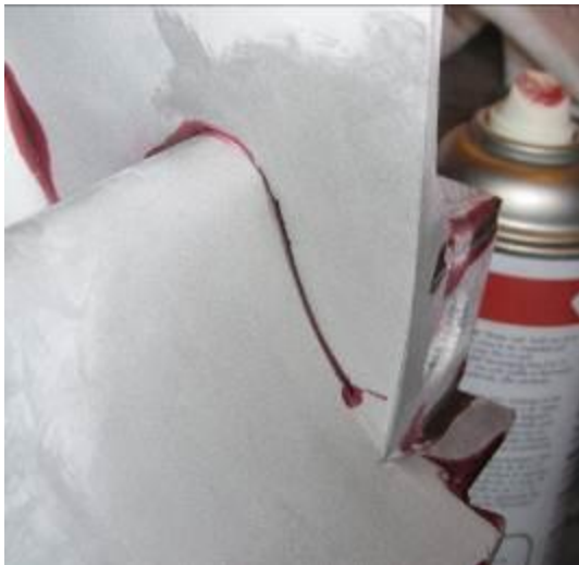
照片 3：氣機第二級靜葉環上半 L 側第 1 只靜葉片本體有 9mm 裂痕
