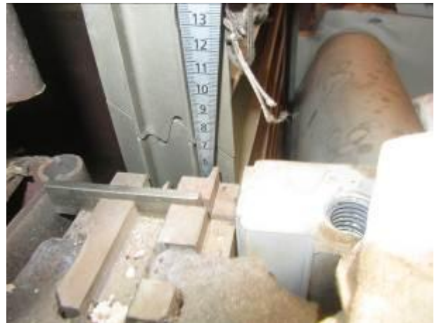
照片 2：氣機#2 級動葉與汽封環間隙量測
