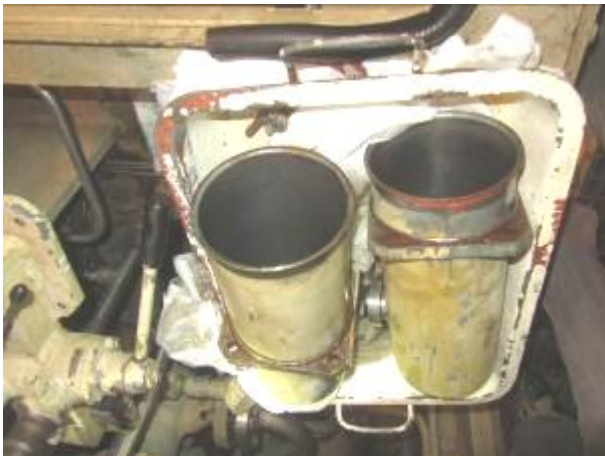
照片 27：液壓油過濾器拆檢
