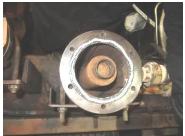
照片 30：儀用空氣過濾器更新
