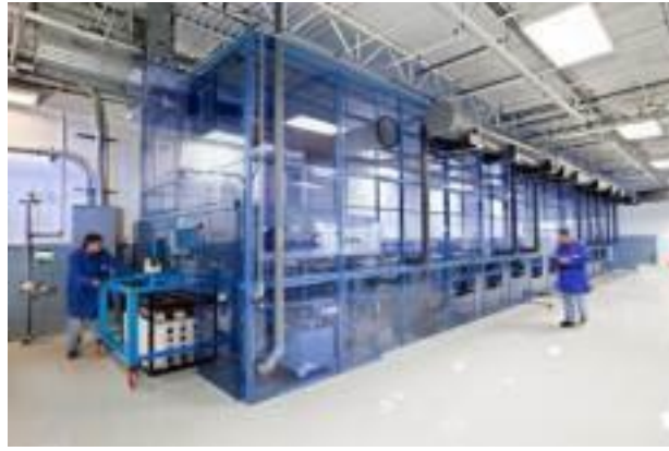
圖 49 化學去塗層設備。
