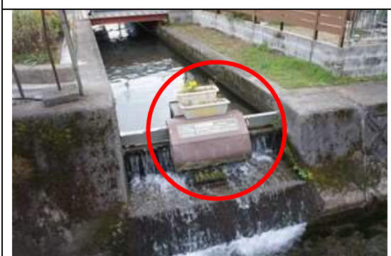
利用水圳高差發電
