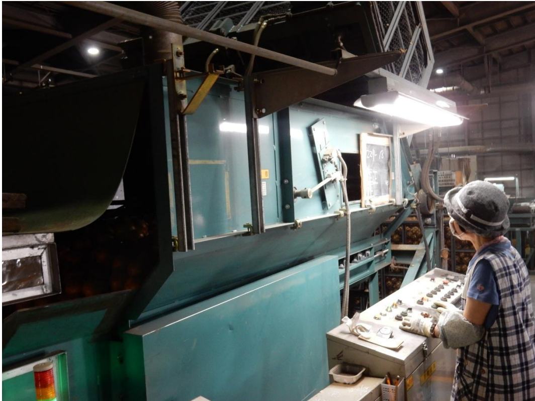
該廠使用電控方式管理及操作選別設施運作
