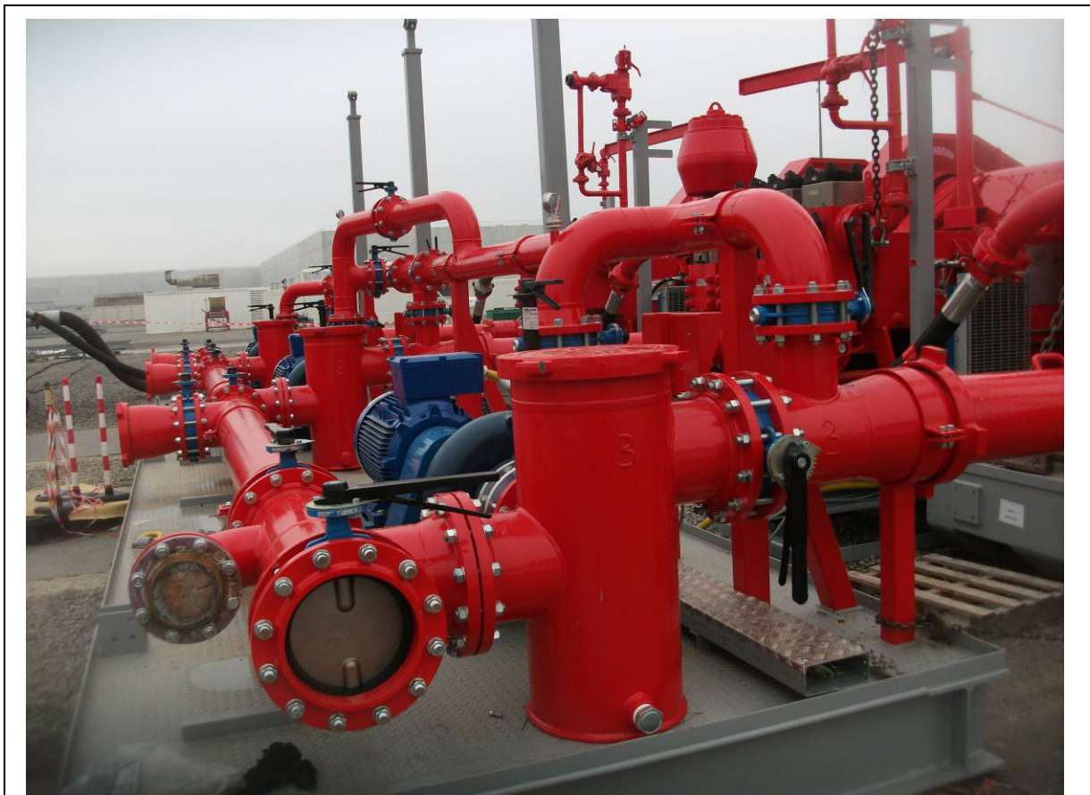
照片十七 增壓泵低壓管線組
