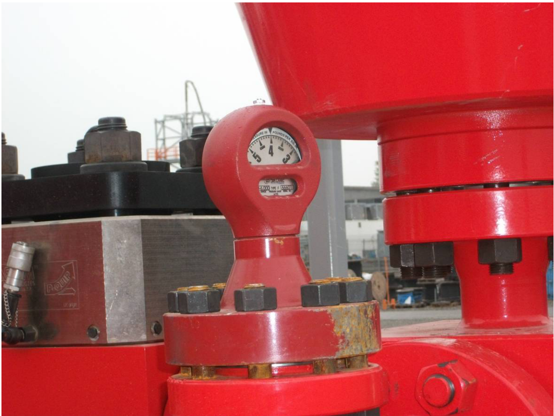
照片六 泥泵壓力測試表
