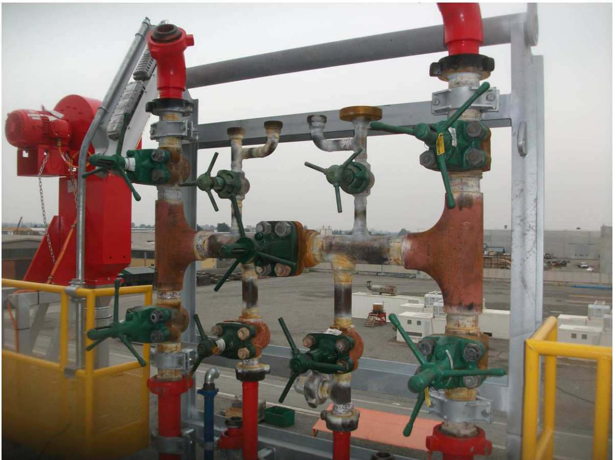
照片十六 鑽井平台高壓歧管組
