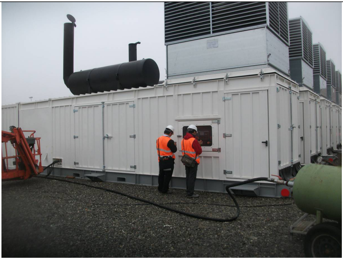
照片二十 引擎發電機組
