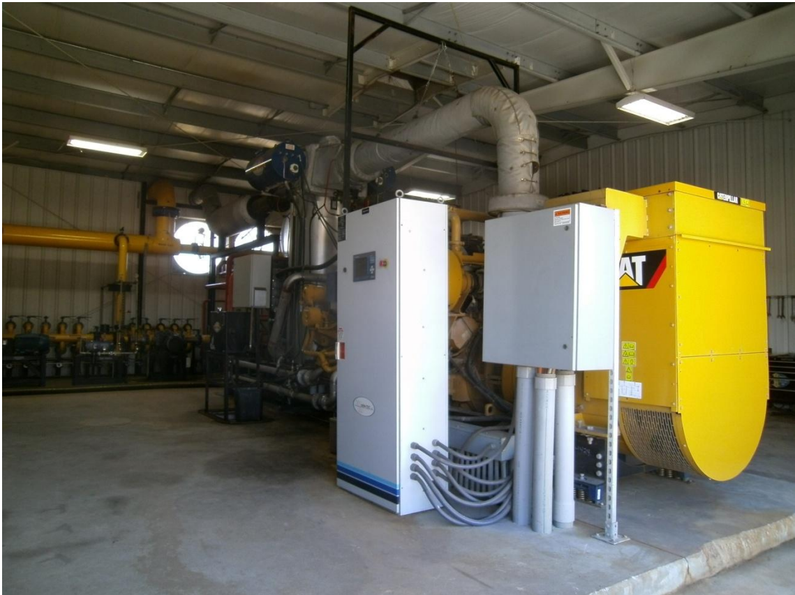
圖 44 沼氣發電設備
