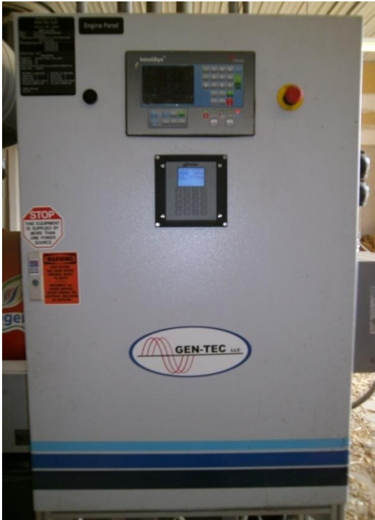
圖 11 沼氣發電機控制盤
