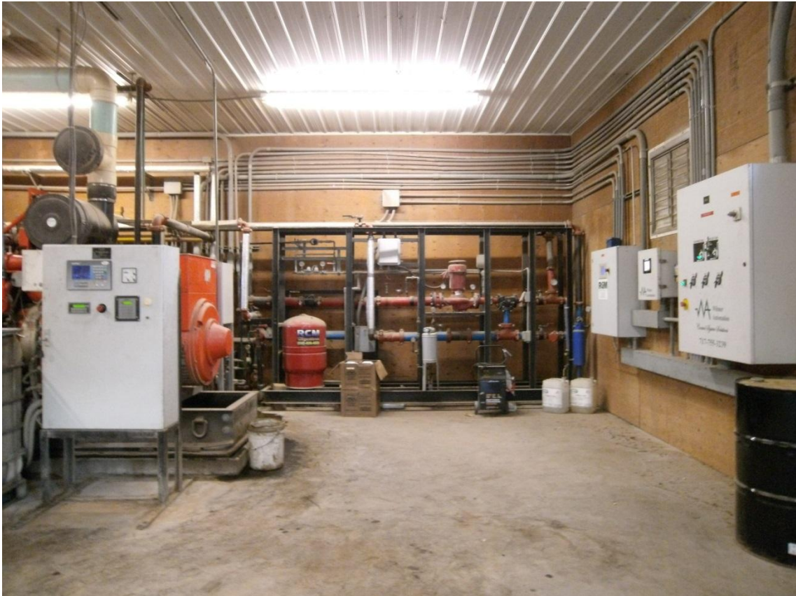
圖 24 沼氣發電機設備機房
