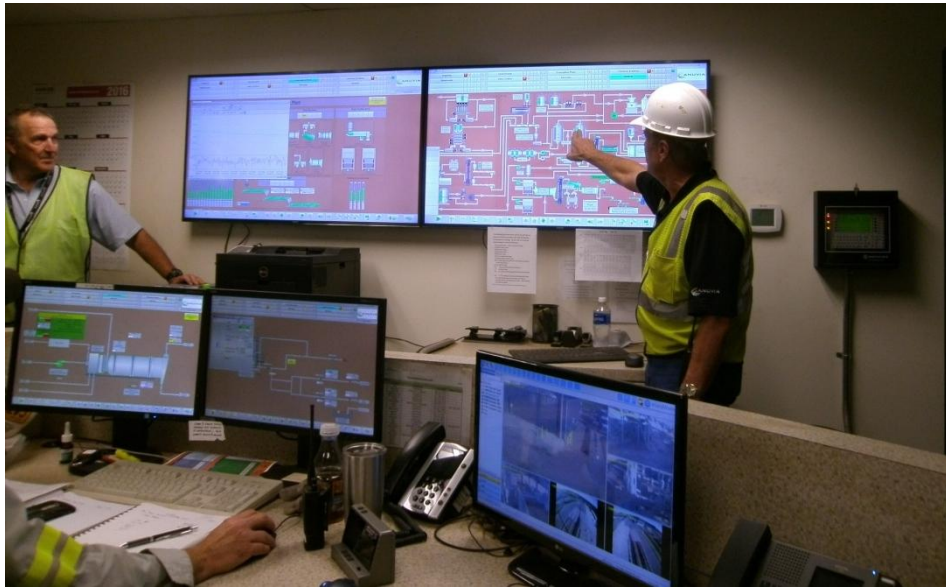
圖 37 控制室儀表板監控場內肥料製造過程
