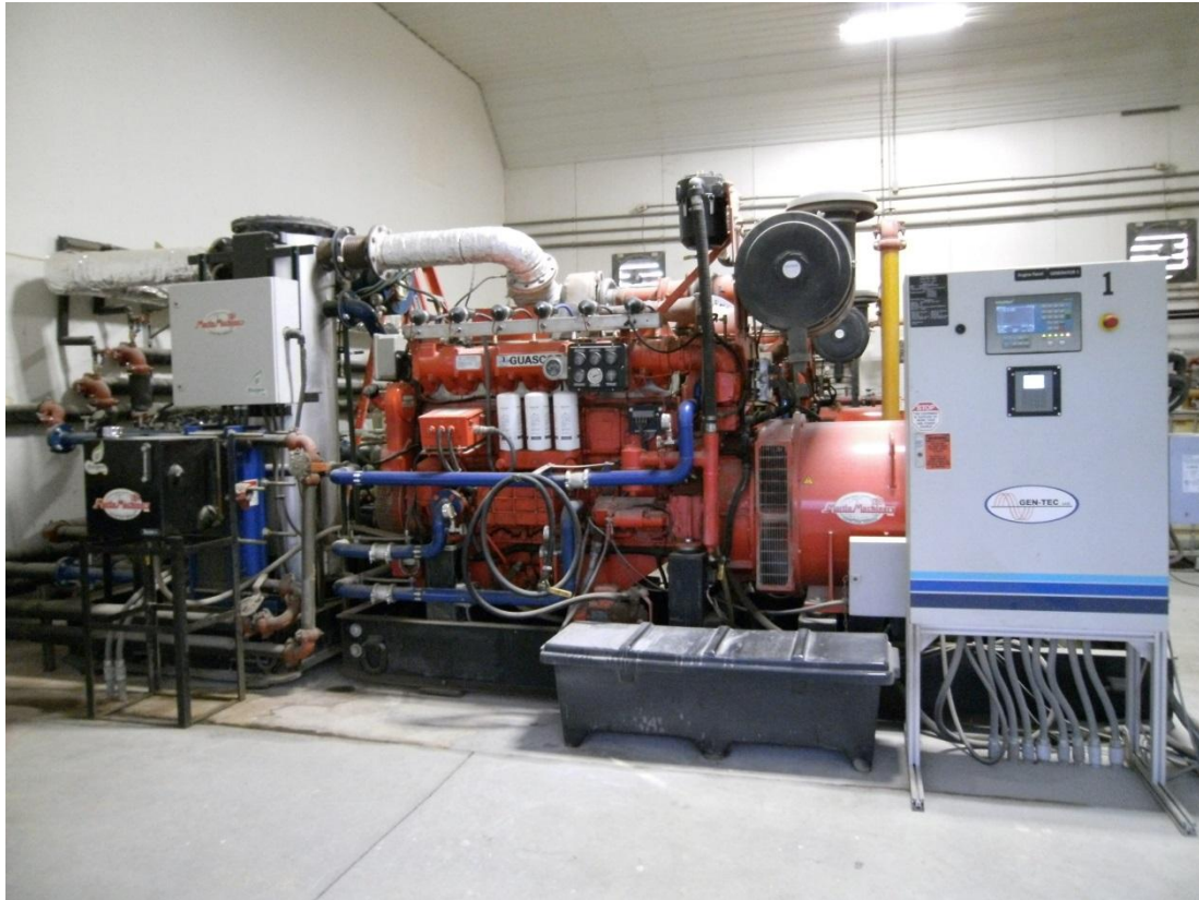
圖 29 沼氣發電機設備機房
