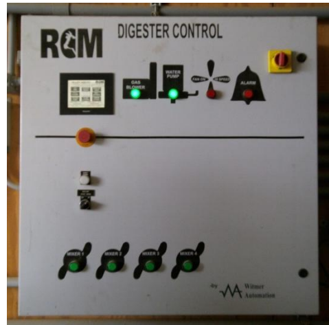
圖 13 厭氧消化設備控制盤
