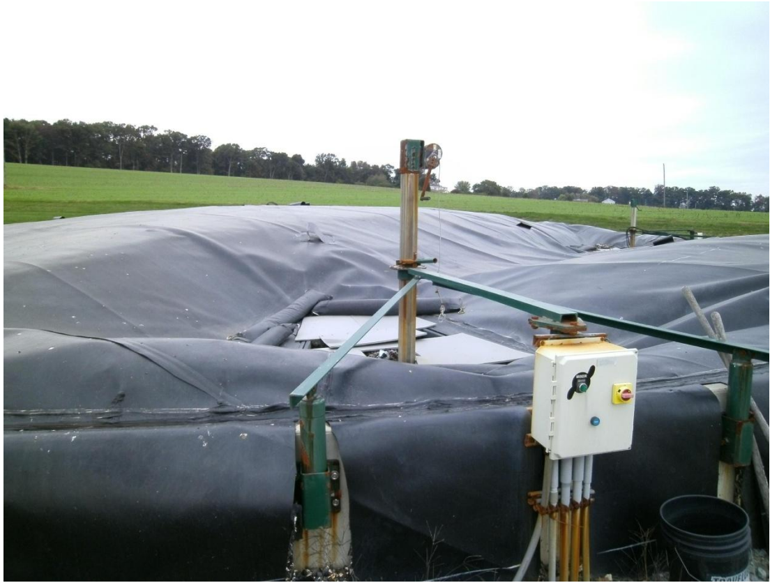
圖 4 沼氣收集設備
