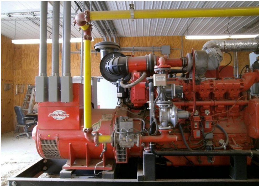
圖 14 沼氣發電設備
