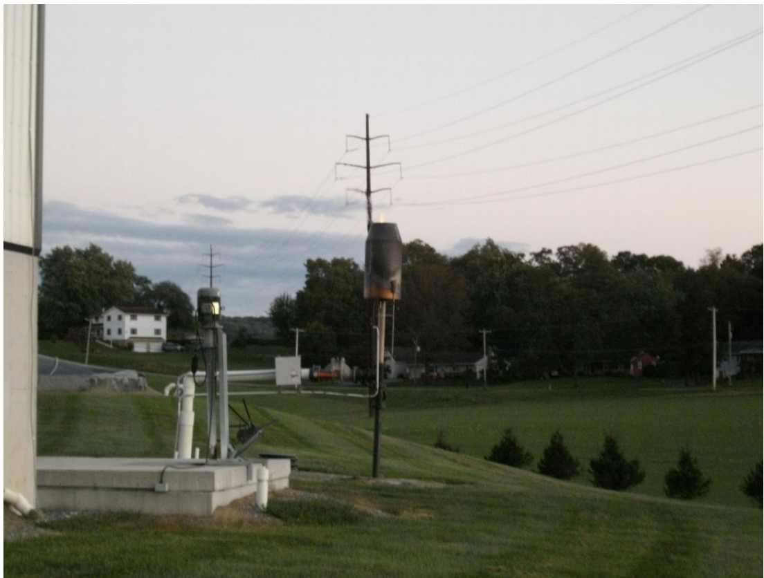
圖 28 供電網及燃燒多餘沼氣
