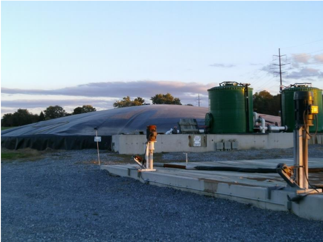
圖 25 沼氣收集袋(地下為厭氧消化槽)
