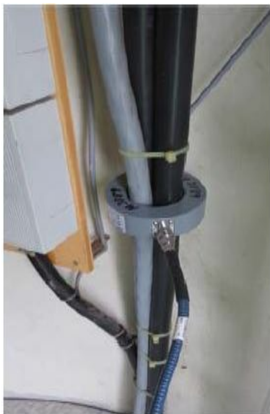
圖 6-1 電流探棒配置於 240 千瓦之 風力發電機的電力線纜周圍
