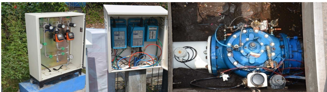
圖 25 PDAM 水務公司 PRV 安裝控制系統情形
