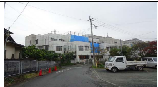
上圖：社區綜合醫院現代建築，外牆及部份地基受損，目前使用中
