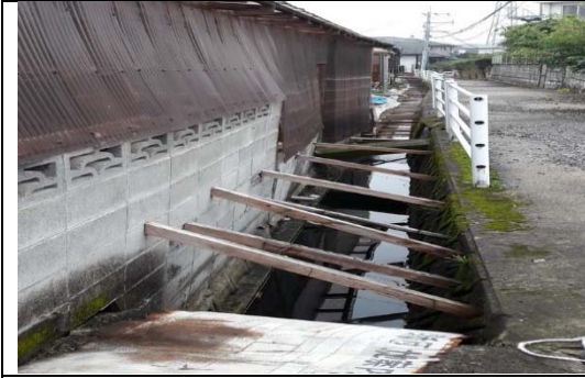
上圖：傾斜的圍牆用木棍加強支撐
