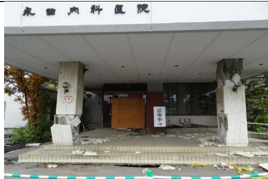
上圖：社區內貼紅單危險之公共建築-內科醫院，目前移別處恢復看診。
