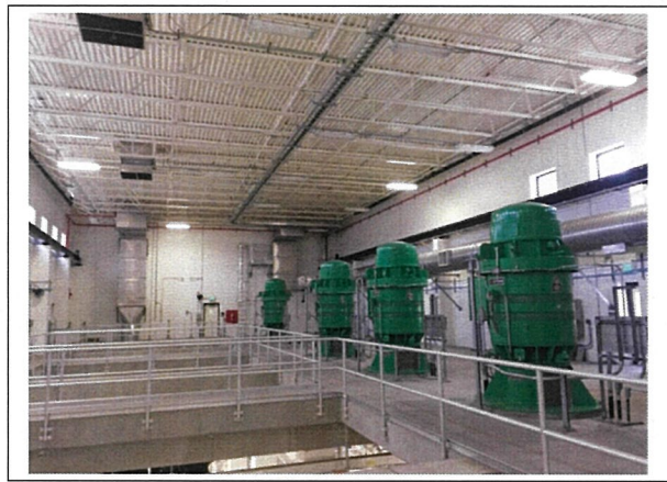
圖 42 出流水抽水機房
