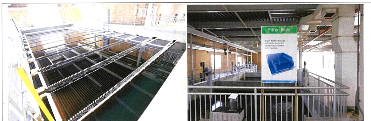
圖 48 本廠傾斜板沉澱池及深層快濾池
