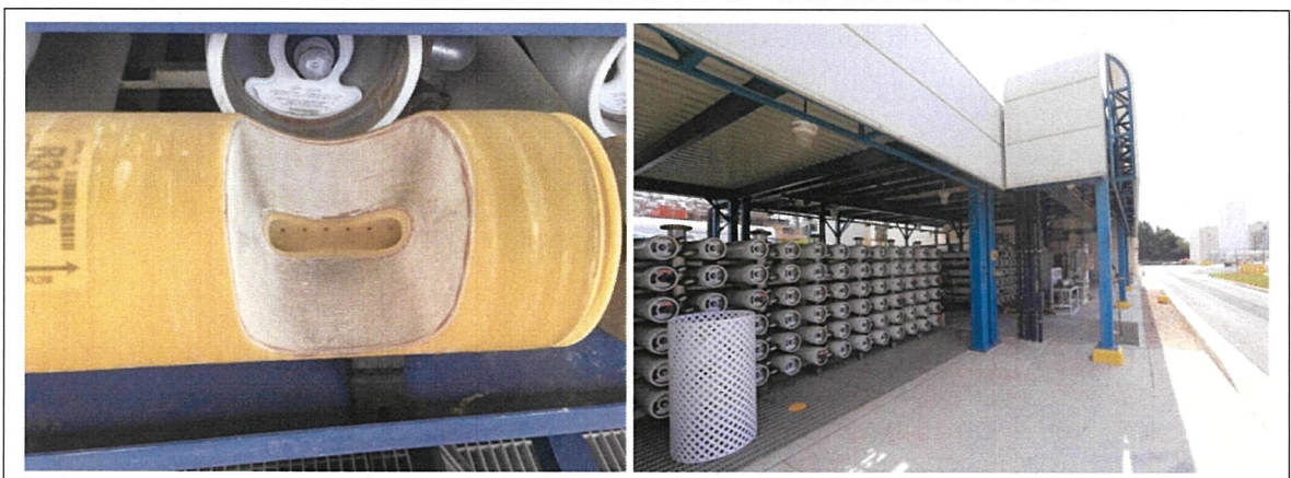
圖 9 本廠 RO 所採用的膜型式及 RO 之模組單元操作情形
