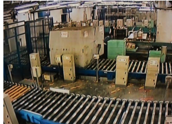
圖 4.4.6 機場站託運行李餵入 BHS 系統
