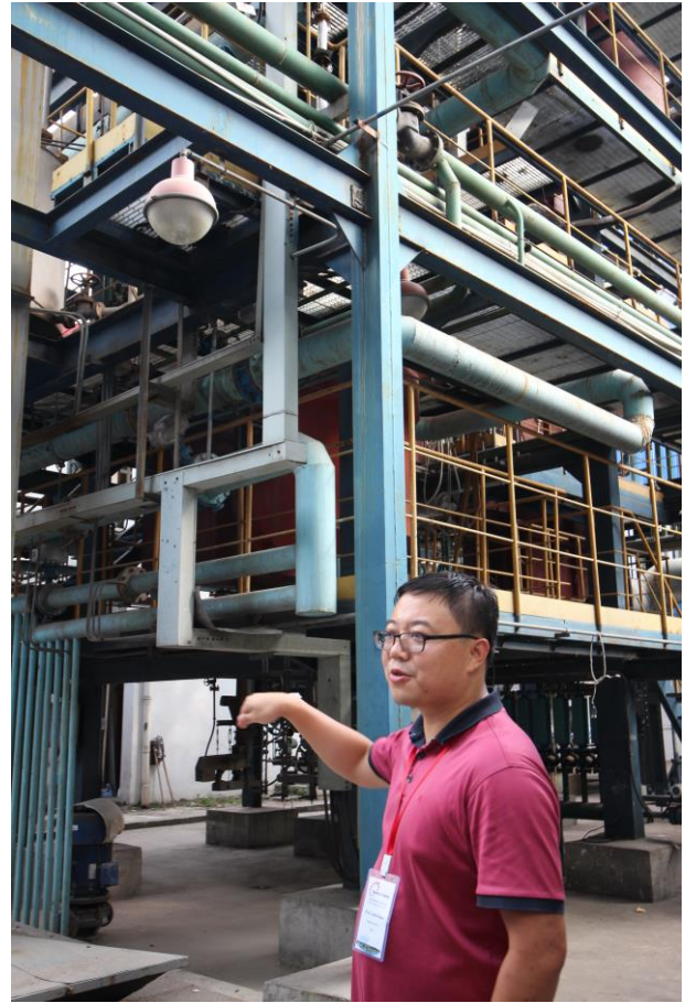
圖 94. 東南大學流體化床氣化爐現場講解
