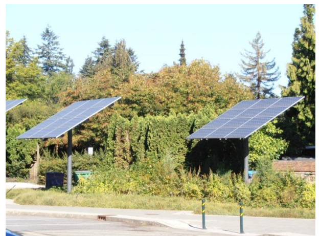
圖 3-4 設置太陽能系統供園區用電自給自足
