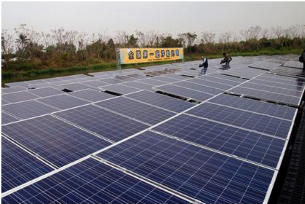
圖 4-4 屏東縣佳冬鄉武丁抽水站前池浮動式太陽發電系統
