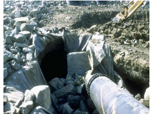
渠道出水口滲漏
