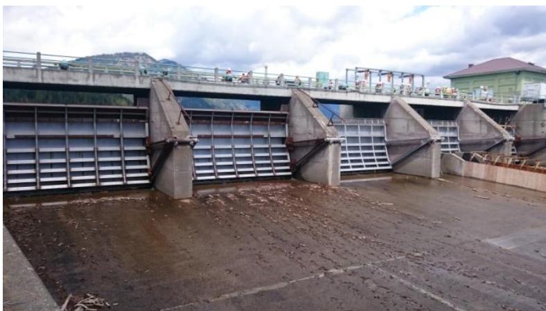
閘門及臨時性魚道
