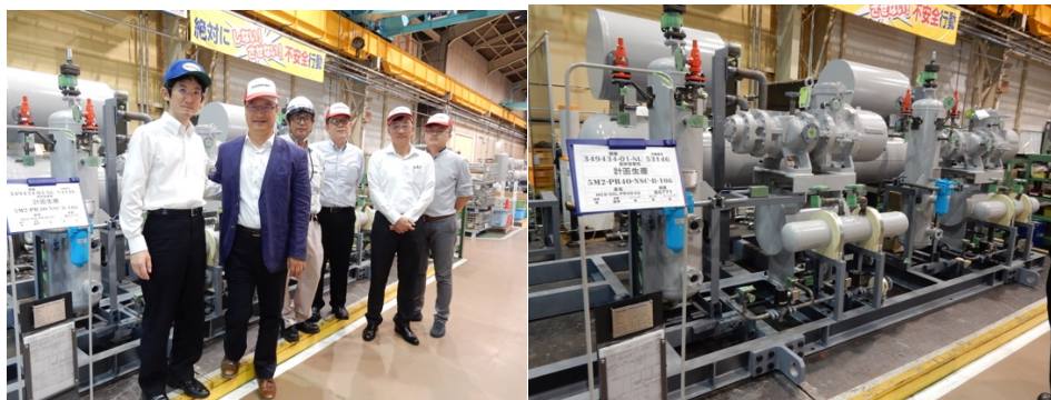
圖十五、與前川製作所人員於倉庫冷凍壓縮機組生產產線與機組
